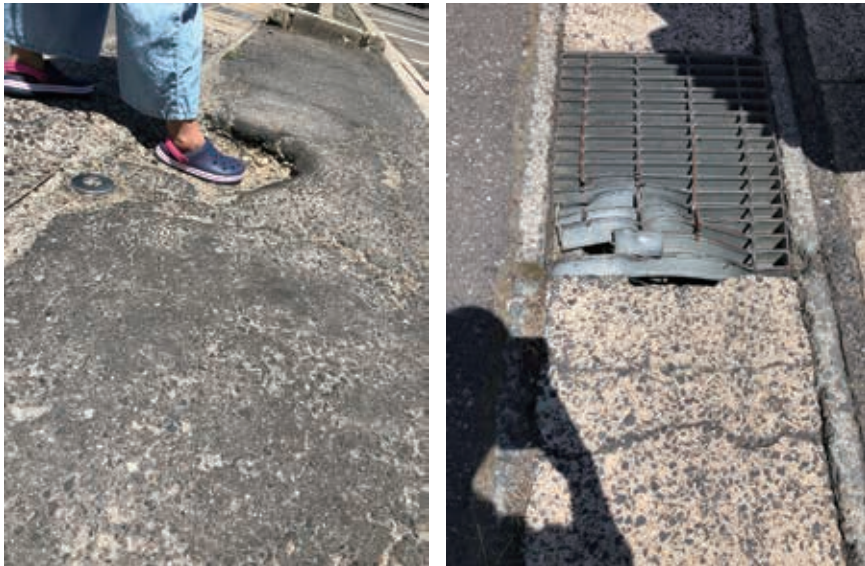
図33 エリアA・A-2コースにおける危険ゾーンの一例
