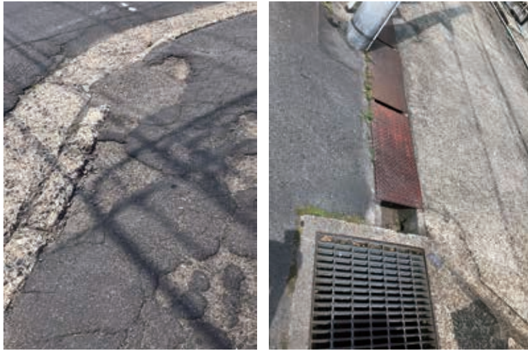
図65 エリアD・D-1コースにおける危険ゾーンの一例
