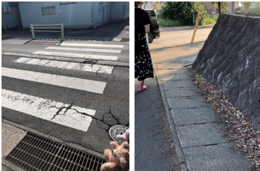
図27 エリアA・A-1コースにおける危険ゾーンの一例
