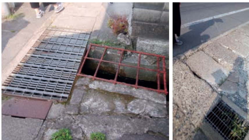
図59 エリアC・C-2コースにおける危険ゾーンの一例
