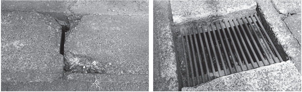
図29 エリアA・A-2コースにおける危険ゾーンの一例
