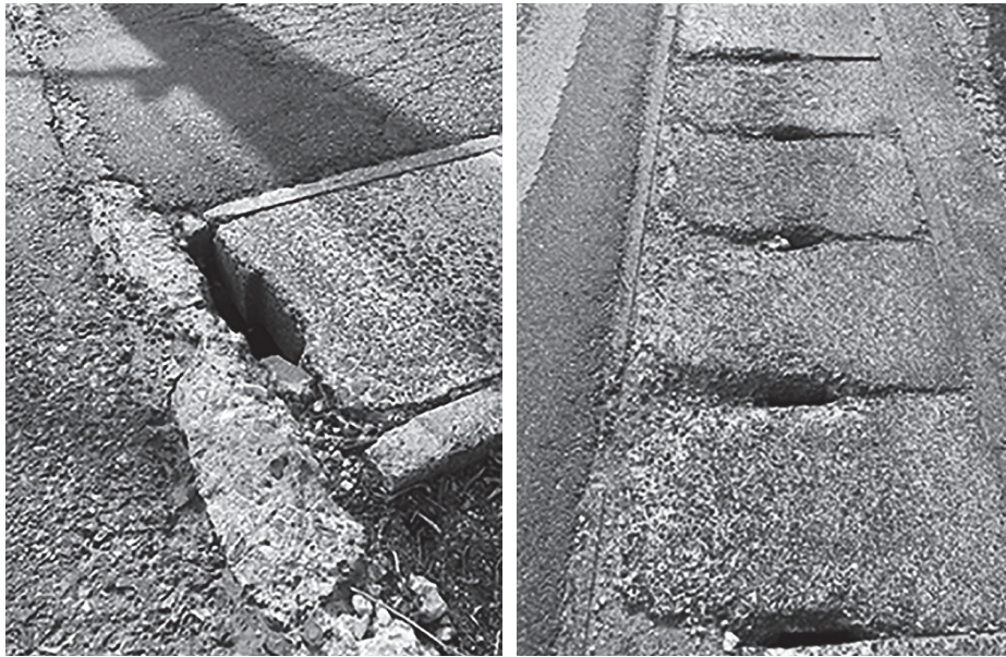
図18 エリアA・A-1コースにおける危険ゾーンの一例
